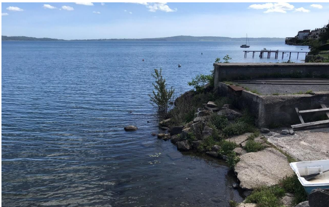
Figura 2. Fotografia testata struttura di coronamento (banchina) incompiuta
